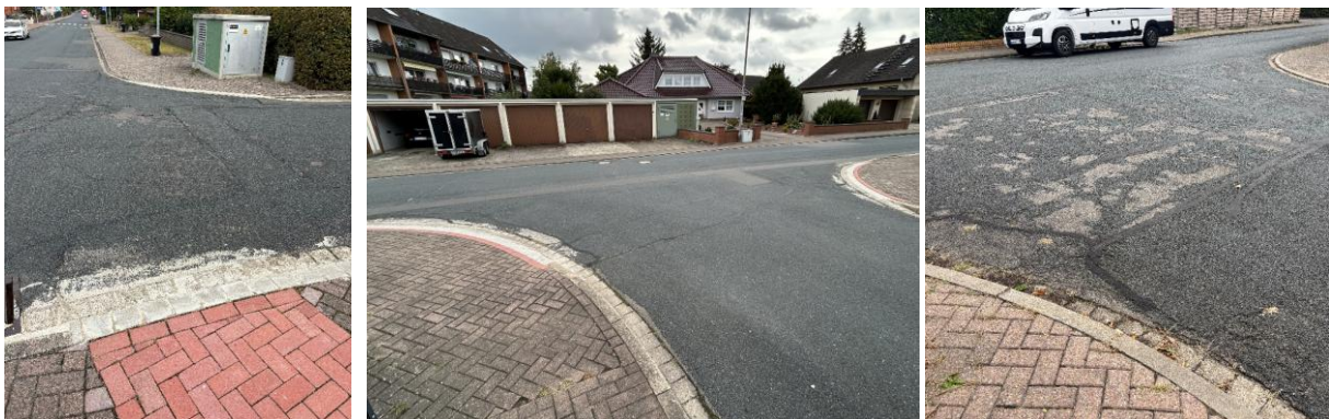
Abbildung 8: Nachträglich abgesenkte Bordsteine in der Bergstr. (links), im Habichthorst (mittig) und weiterhin vorhandene nicht abgesenkte Bordsteine in der Dresdener Str. (rechts)
