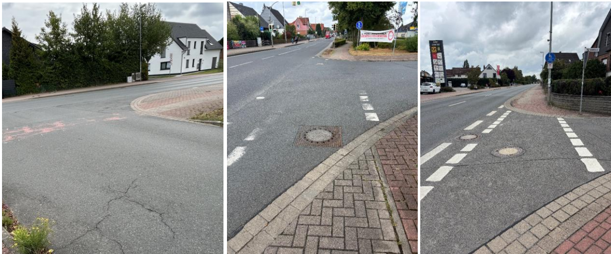
Abbildung 20: Teilweise abgetragene Markierungen Landesstraße Höhe Starenweg (links), Falkenberger Str. (mittig) und einfache Markierungen Höhe Hasenwinkel (rechts)
