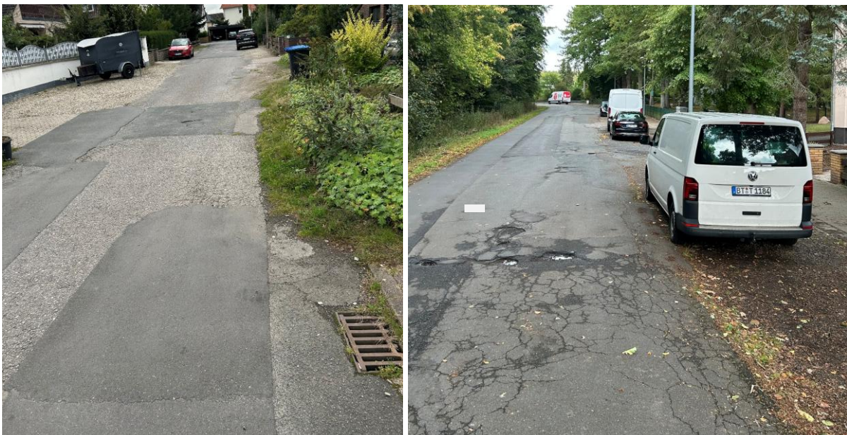
Abbildung 19: Beschädigte Straßenoberfläche im Mardersteg (links) und Heinrich-Kobbe-Str. (rechts)
